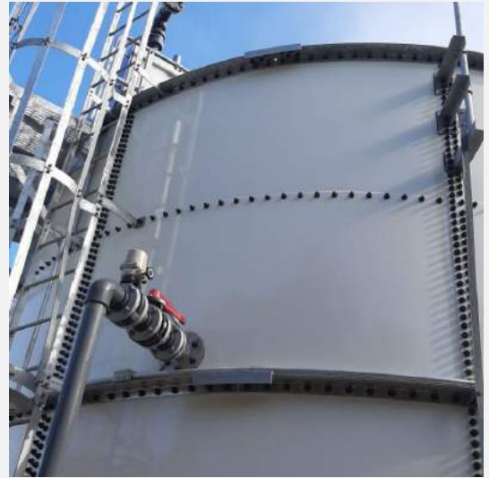
Foto 6: Reactor biológico después de la limpieza por rebose.
