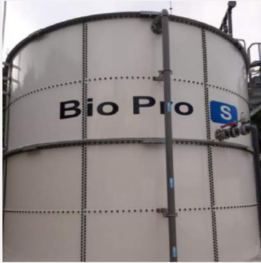
Foto 5: Reactor biológico después de la limpieza por rebose.
