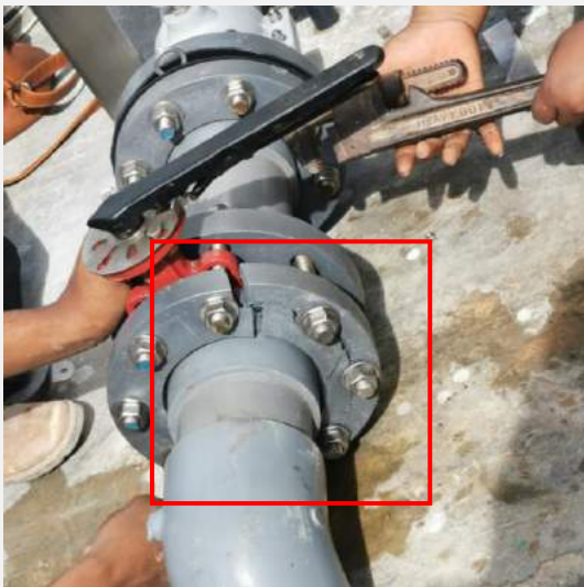
Foto 15: Ruptura de la brida de la línea del soplador 2.
