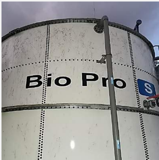
Foto 3: Rebose de espumas en reactor biológico.
