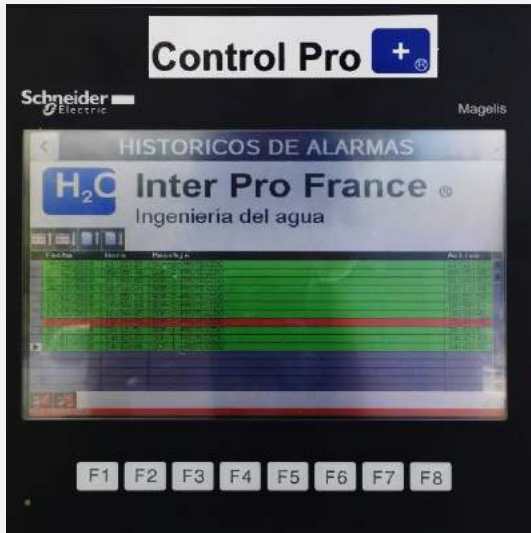
Foto 9: Protecciones de los sopladores 1 y 2 por variaciones de voltaje.
