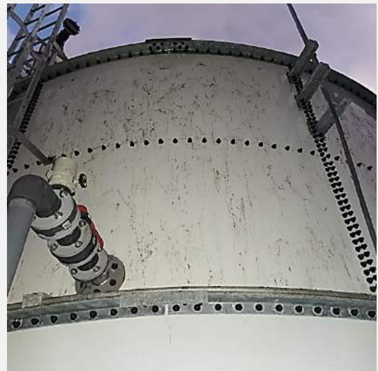
Foto 4: Rebose de espumas en reactor biológico.
