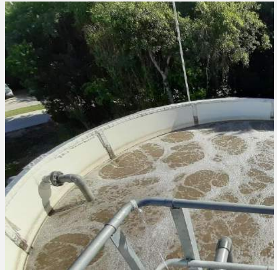
Foto 8: Eliminación de espumas en reactor biológico.
